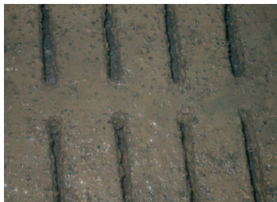
Fessurato in cemento usurato: si noti la difformità degli spazi e la fuoriuscita da calcestruzzo della ghiaia che provoca dolore ed eccessiva usura dell'unghia
